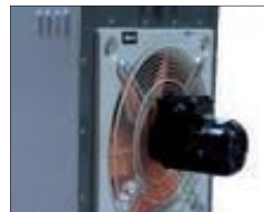
Detalle ventilador. View of the fan.
